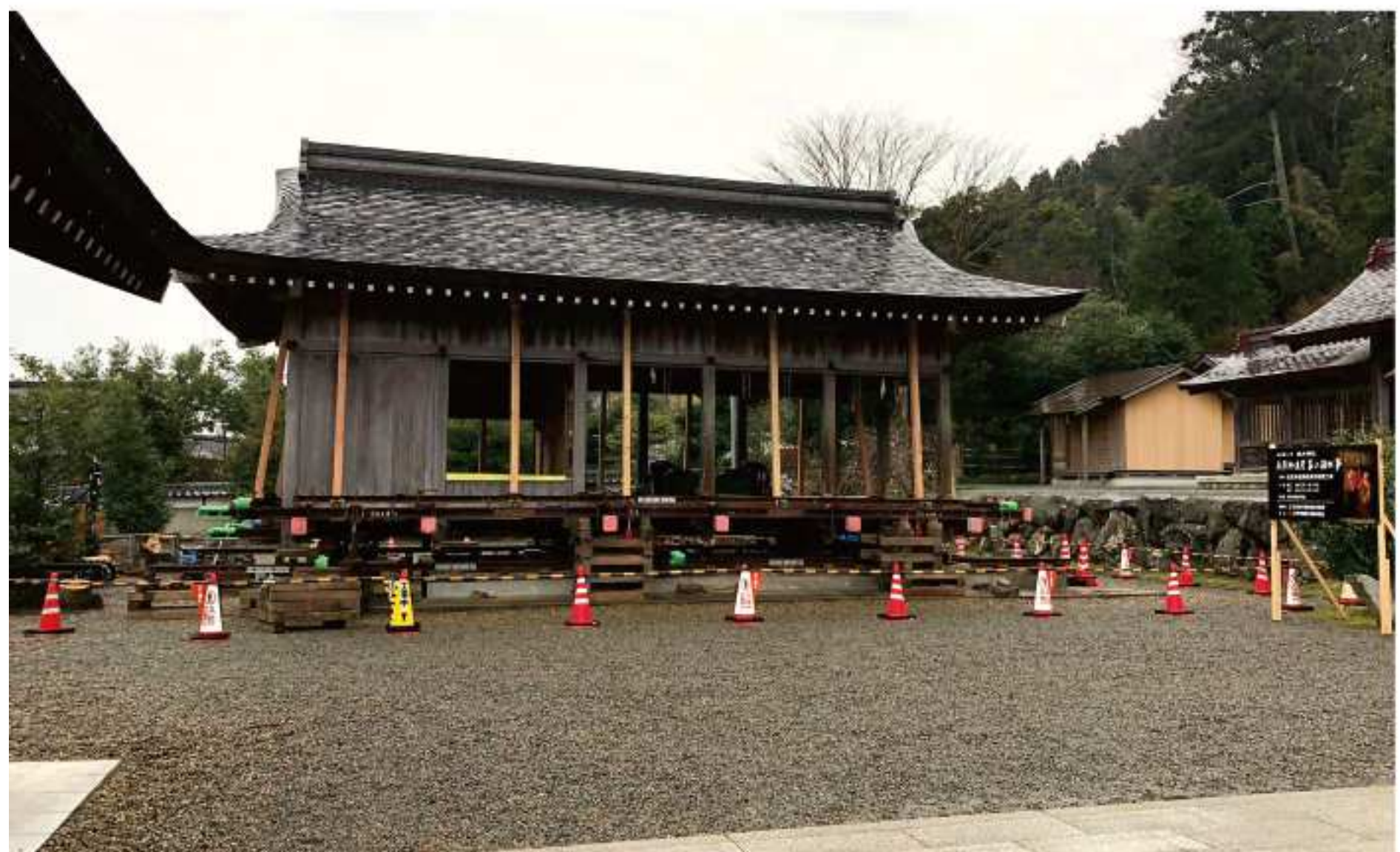
佐陀神能舞殿保存修理工事 設計：石原社寺建築設計事務所 施工：カナツ技建工業 株式会社 工期：令和2年1月16日～令和3年6月末
